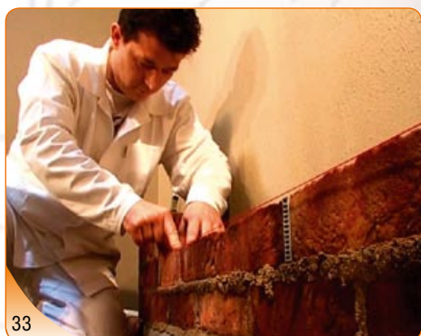
Při pokládání cihel ihned po jejich položení provádíme jejich konečné usazení do požadované polohy.
