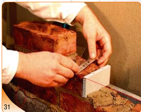
Při vyzdívání ploch zdiva se používá v převážné míře systém vyzdívání tzv. do šňůrky.
